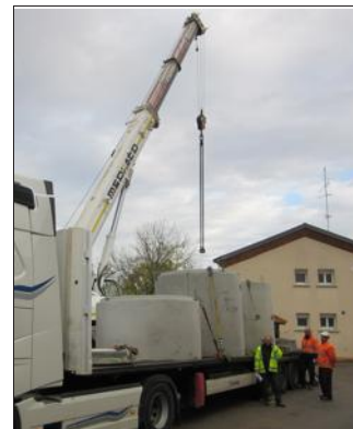
Avec prudence et doigté, la grue met en place les fosses du poste de refoulement.
